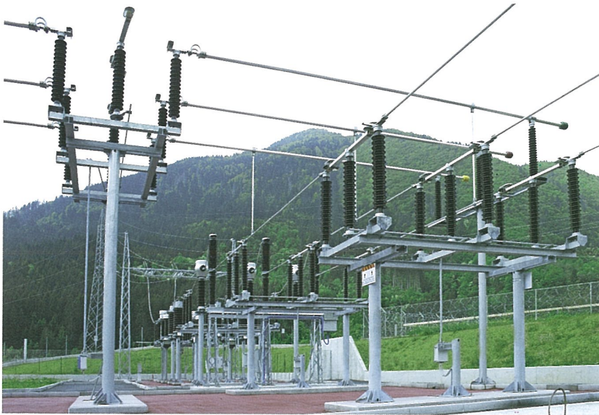
Particolari delle apparecchiature del reparto 132 kV.
