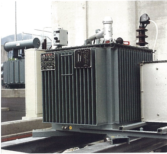
La reattanza per il collegamento a terra del conduttore neutro della rete a 20 kV ( bobina di Petersen ).
